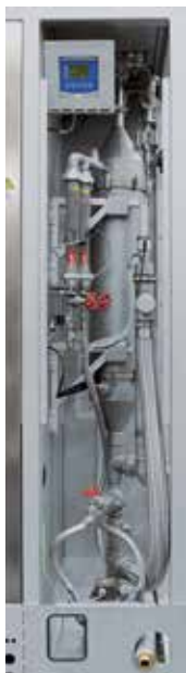
Система очистки технологических газов методом промывки
